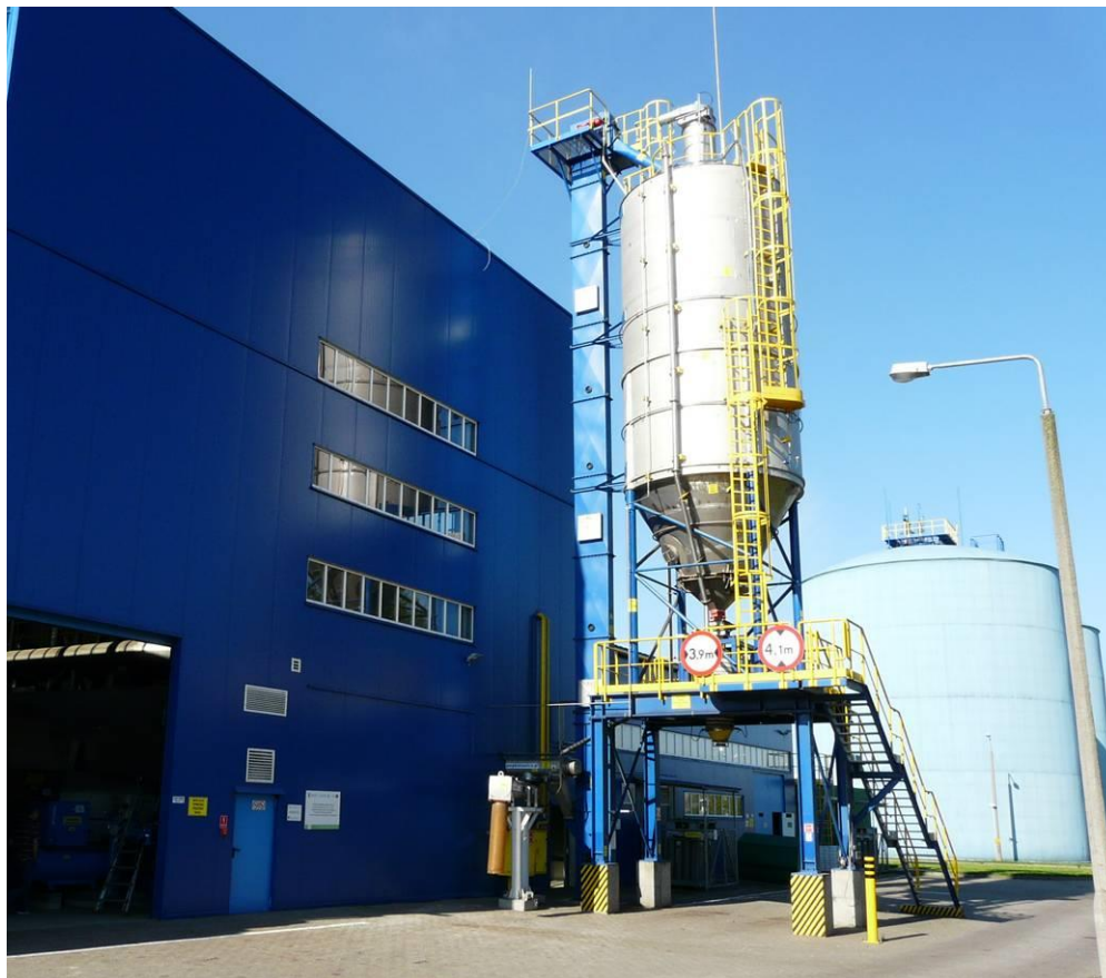
Budynek stacji termicznej przeróbki osadu, korpus suszarni, palnik z wentylatorem cyrkulacyjnym
