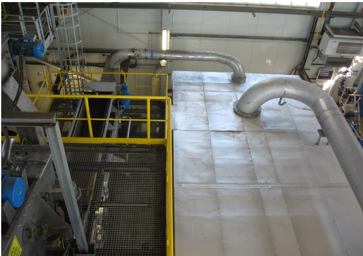
Korpus taśmowej suszarni osadu, chłodnica osadu wysuszonego
