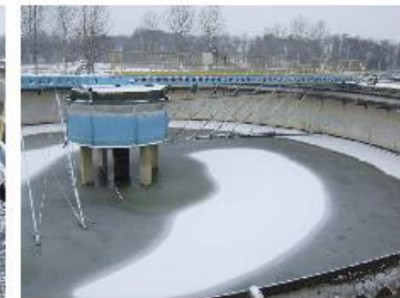
Jeden z osadników wtórnych (czasowo wyłączony)
